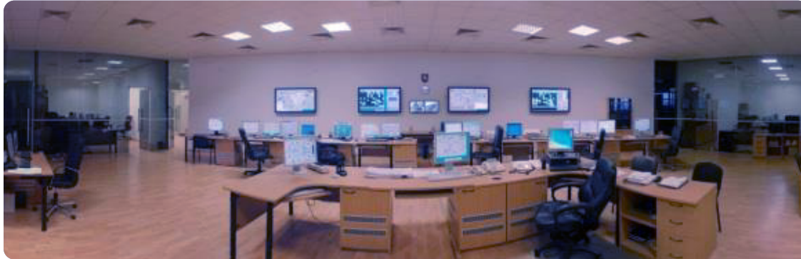
Blokinis valdymo pultas po modernizavimo
